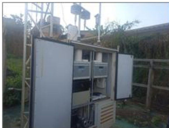
Figura 43 - Estação de Monitoramento de Qualidade do Ar Pires.
