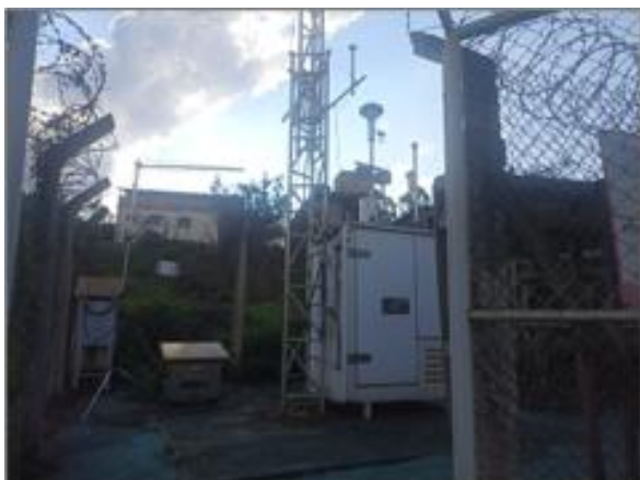
Figura 42 - Estação de Monitoramento de Qualidade do Ar Pires.
