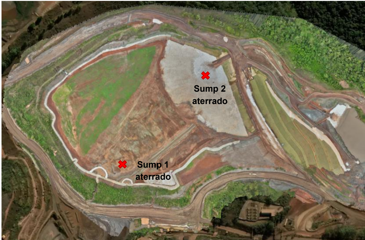
Figura 88 – Tamponamento do Sump 1 e do Sump 2 na barragem de Área IX (data: 03/12/2025).
