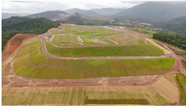
Figura 11 – Canaletas de Drenagem - Jan/26
