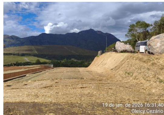
Figura 28 - Aplicação de biomanta de capim e biorretentores na extremidade do canal lateral, próximo ao emboque do tunnel liner Fonte: Vale, 2025.
