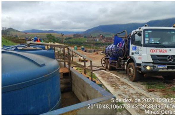
Figura 49 – Sucção de efluente do tanque séptico.
