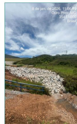
Saída do filtro
