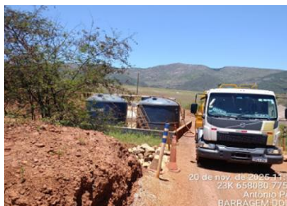
Figura 49 - Sução da caixa de acumulação de efluente sanitário. Fonte: Vale, (2026).
