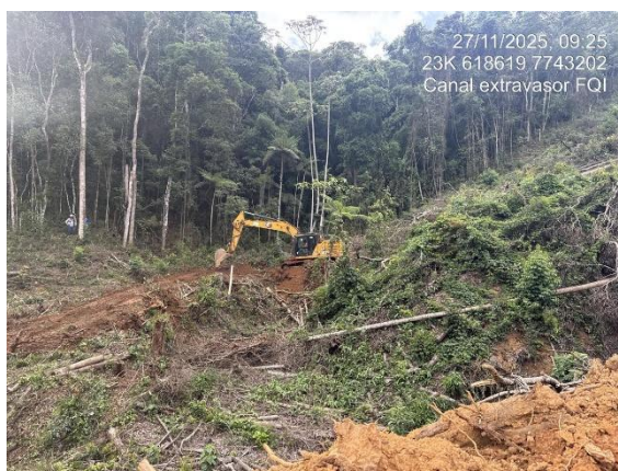
Figura 37 – Atividades de remoção de topsoil na Ombreira esquerda da barragem Forquilha I - Mina de Fábrica. Fonte: Concremat, 2025.
