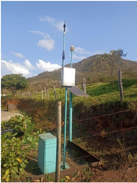
Figura 34 - Estação de Monitoramento de Ruído de Pires. Vale, 2023.
