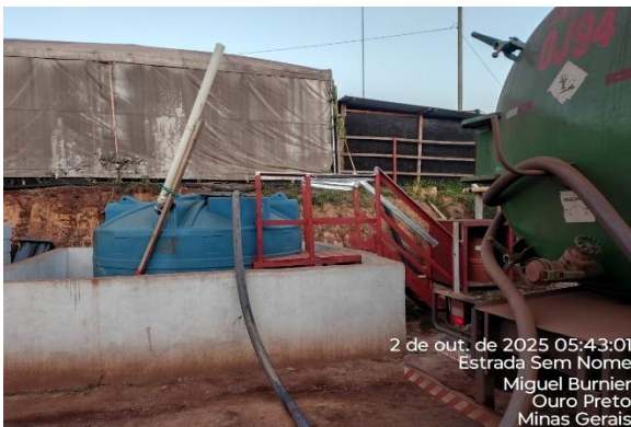
Figura 83 – Recolhimento de efluentes do tanque séptico localizado no canteiro. Fonte: Vale, outubro de 2025.
