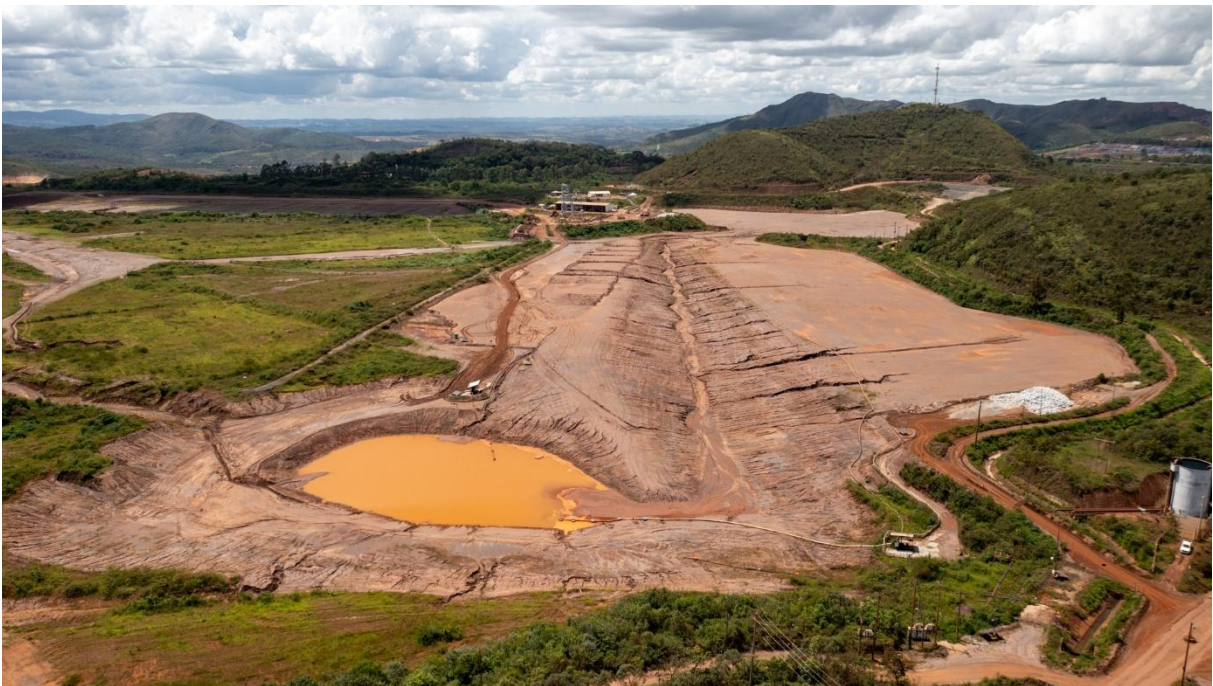
Figura 23 - Sistema de bombeamento Sump 1 (janeiro/2026).
