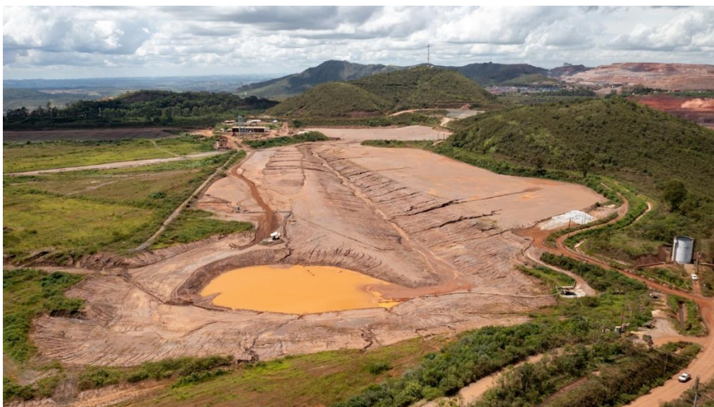
Figura 7 - Sistema de bombeamento operacional Sump 1 (janeiro/2026).
