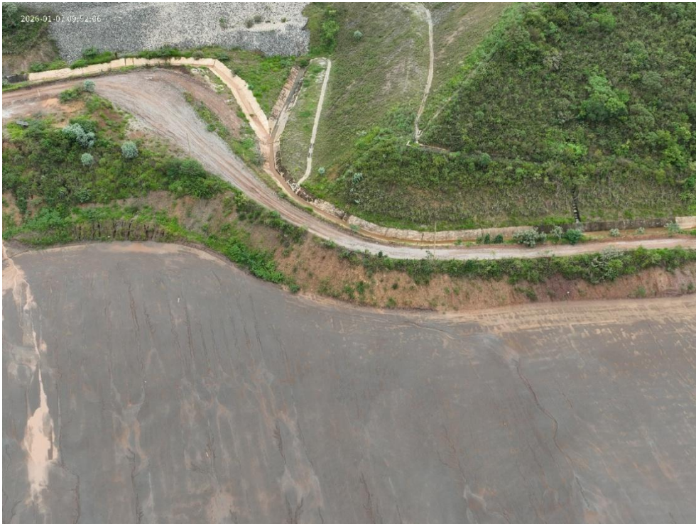
Figura 28 - Inspeção geral canais de cintura Forquilha I (janeiro/26)
