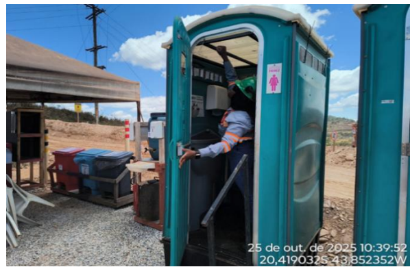
Figura 84 – Recolhimento de efluentes dos tanques sépticos. Fonte: Vale, outubro de 2025.
