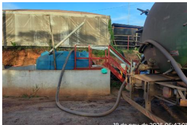
Figura 86 - Sucção de efluentes sanitários armazenados nos tanques sépticos. Fonte: Vale, novembro de 2025.
