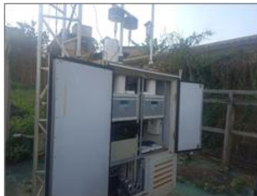
Figura 56 - Estação de Monitoramento de Qualidade do Ar Pires. Fonte: Vale, 2023.
