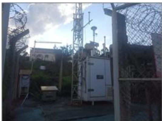
Figura 55 - Estação de Monitoramento de Qualidade do Ar Pires. Fonte: Vale, 2023.
