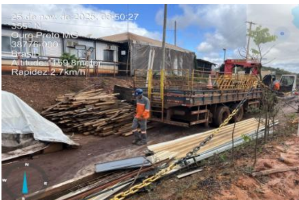
Figura 88 - Recolhimento de resíduos para o transporte interno até o CMD - Forquilhas I/II. Fonte: Vale, novembro de 2025.
