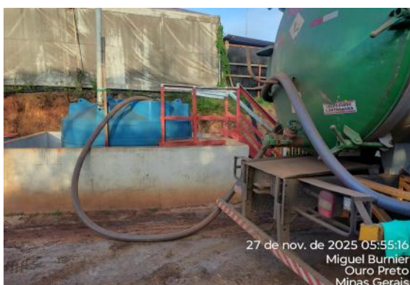
Figura 78 - Recolhimento de efluentes do tanque localizado no Pátio da Oficina de Forquilha I/II. Fonte: Vale, novembro de 2025.
