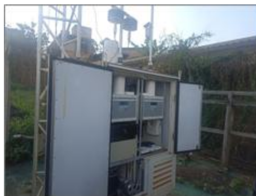
Figura 49 - Estação de Monitoramento de Qualidade do Ar Pires.
