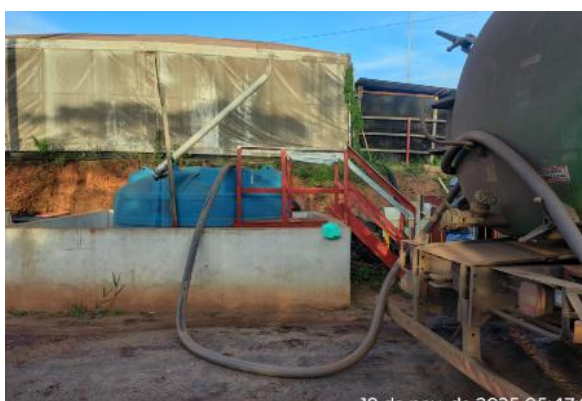
Figura 79 - Sucção de efluentes sanitários armazenados nos tanques sépticos. Fonte: Vale, novembro de 2025.
