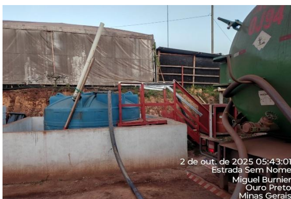
Figura 76 – Recolhimento de efluentes do tanque séptico localizado no canteiro. Fonte: Vale, outubro de 2025.
