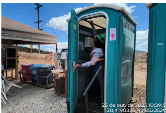
Figura 77 – Recolhimento de efluentes dos tanques sépticos. Fonte: Vale, outubro de 2025.
