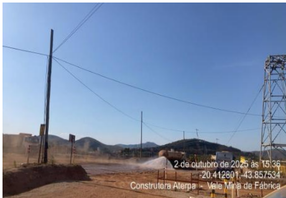
Figura 34 - Atividade de aspersão de água nos acessos de Forquilhas. Fonte: Vale, outubro de 2025.
