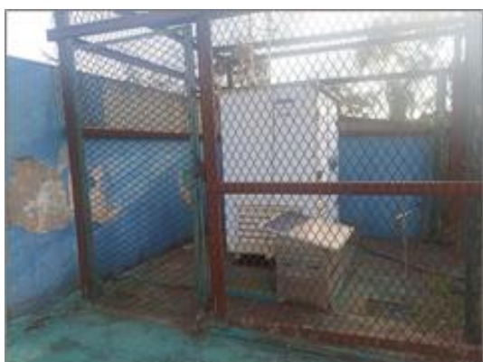
Figura 50 - Estação de Monitoramento de Qualidade do Ar Mota.
