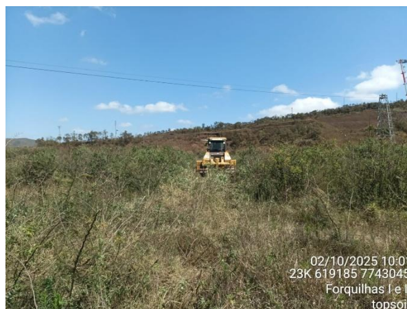
Figura 31 – Realização da atividade de remoção de topsoil na barragem Forquilha I e II. Fonte: Vale, 2025
