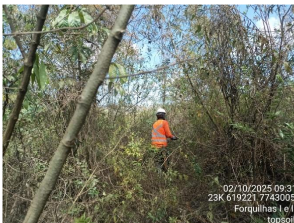
Figura 29 – Vistoria prévia na área de intervenção na barragem Forquilha I e II, atividade de remoção de topsoil . Fonte: Vale, 2025
