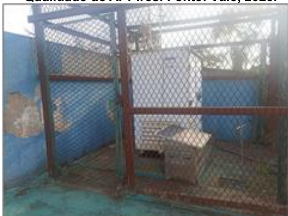
Figura 71 - Estação de Monitoramento de Qualidade do Ar Mota. Fonte: Vale, 2023.
