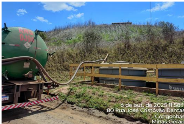
Figura 97 - Sucção de fossa séptica. Fonte: Vale, outubro de 2025.
