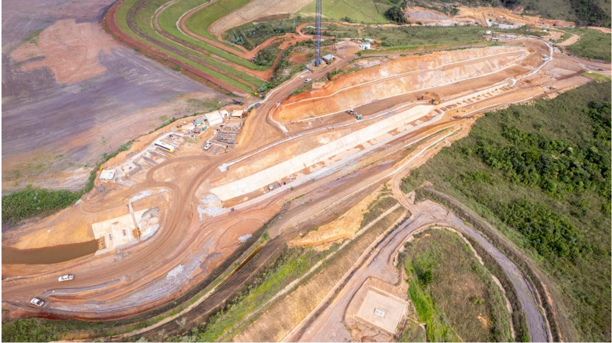
Figura 19 - Canal de Descaracteriza/Desvio – Fora ZAS (janeiro/2026).
