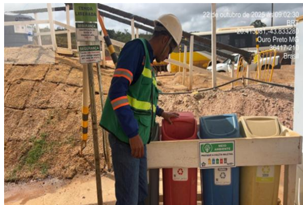
Figura 108 - Inspeção com foco na segregação de resíduos. Fonte: Vale, outubro de 2025.
