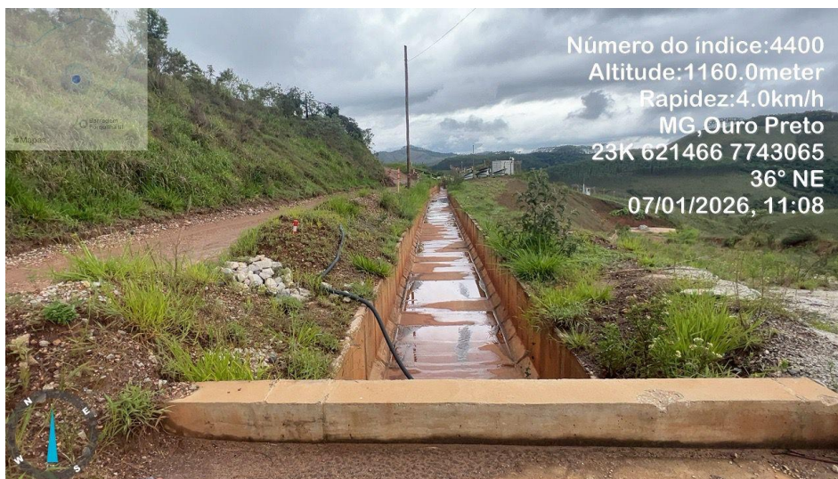
Figura 31 - Estado de conservação dos canais de cintura (janeiro/2026).
