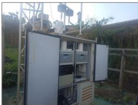
Figura 70 - Estação de Monitoramento de Qualidade do Ar Pires. Fonte: Vale, 2023.
