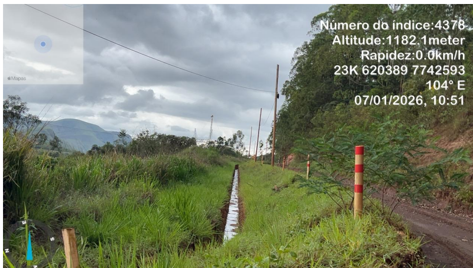
Figura 28 - Estado de conservação dos canais de cintura (janeiro/2026).
