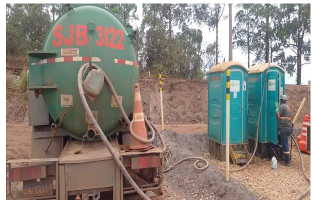
Figura 98 - Sucção de efluente dos banheiros químicos. Fonte: Vale, outubro de 2025.
