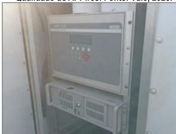
Figura 72 - Estação de Monitoramento de Qualidade do Ar Mota. Fonte: Vale, 2023.
