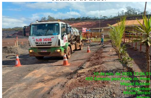
Figura 76 - Sucção de efluentes sanitários armazenados nos tanques sépticos. Fonte: Vale, novembro de 2025.
