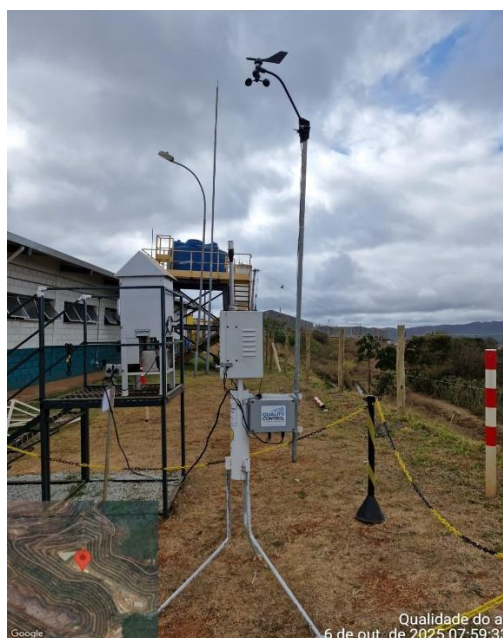
Figura 50 – Opacímetro instalado no canteiro central para medição do MP10 e MP2,5.
