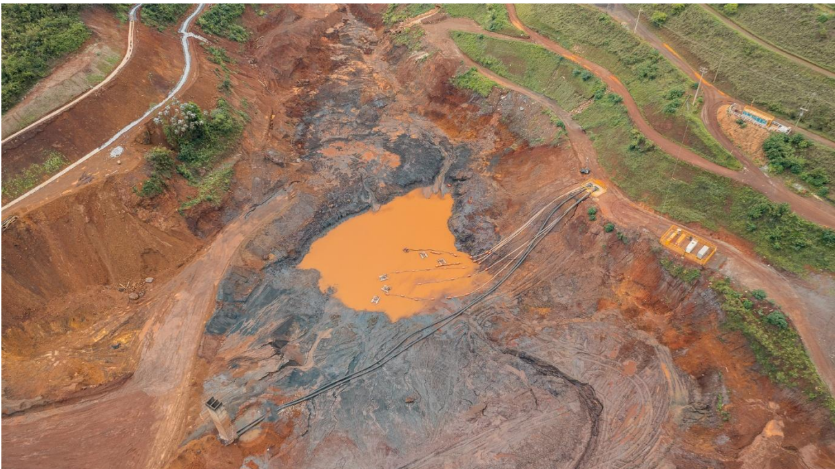
Figura 12 – Sump-Fase2 e sistema de bombeamento direcionando água para tulipa (dezembro/2025)
