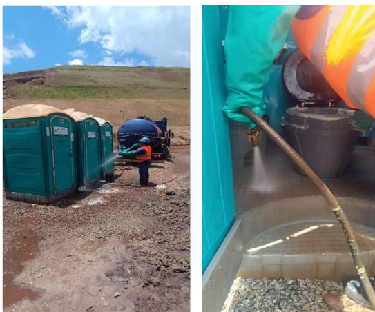
Figura 52 - Limpeza dos banheiros químicos – Frente de Serviço.
