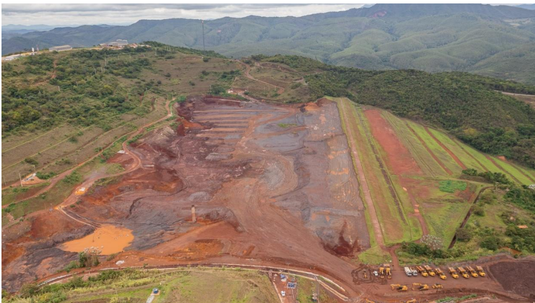
Figura 8 - Visão geral reservatório, sump-fase 2 – sistema de bombeamento de água para tulipa –dezembro/2025.
