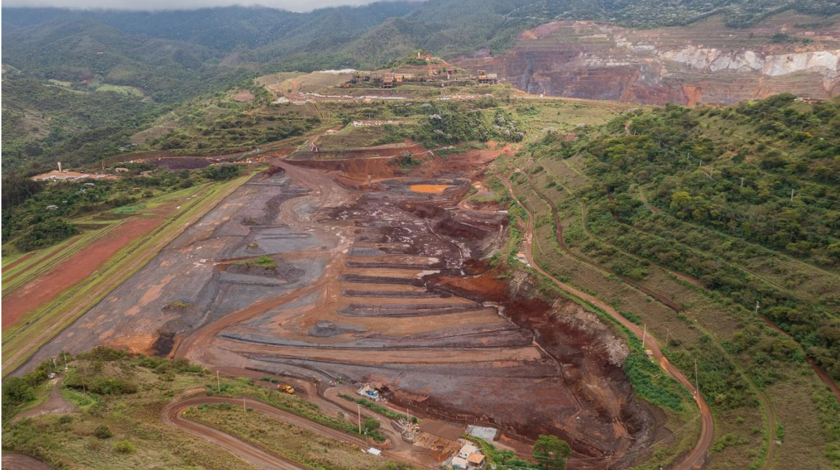
Figura 11 - Vista ombreira esquerda da BSS (dezembro/2025), escavação do reservatório, canal periférico e crista.
