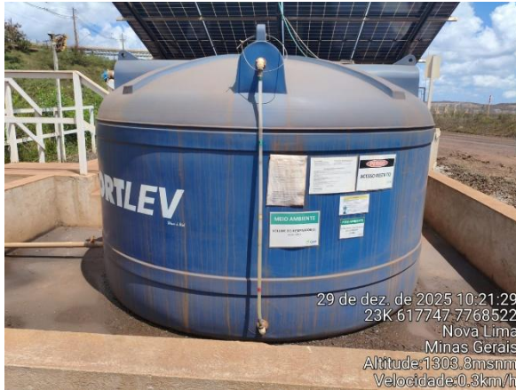
Figura 102 – Vista do tanque de armazenamento de flocculante e abastecimento (Fonte: Vale, dezembro de 2025)
