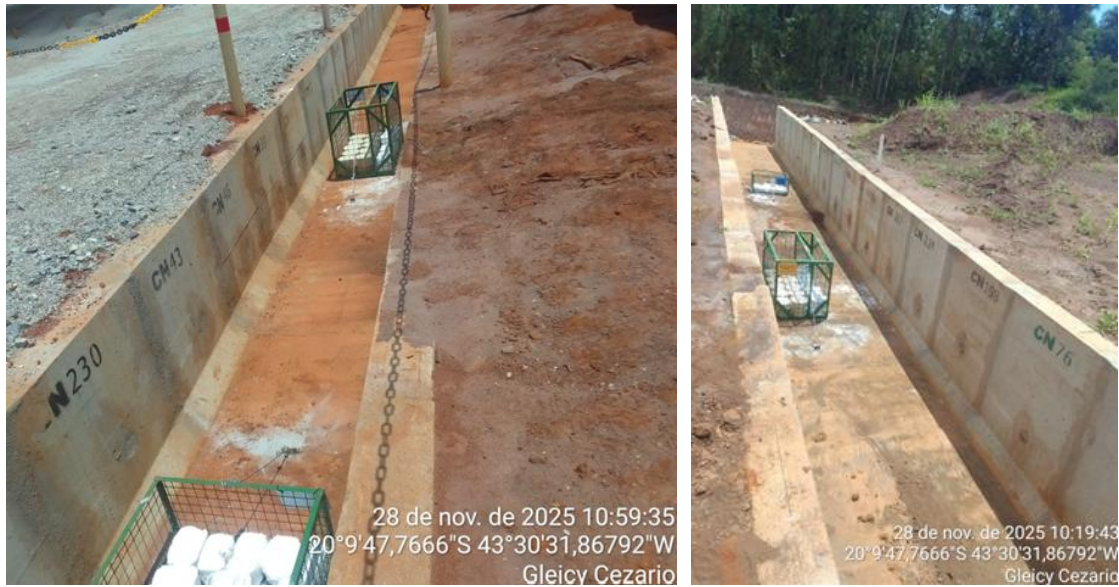
Figura 41 – Abastecimento de pastilhas solúveis nos cestos instalados nas canaletas de entrada dos sumps 01 e 02.
