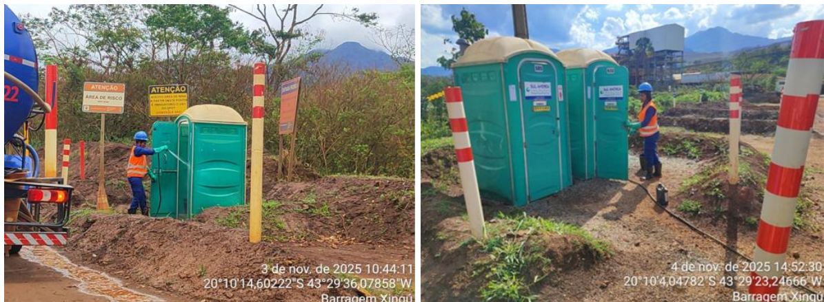
Figura 56 - Limpeza de banheiro químico. Fonte: Vale, 2026.
