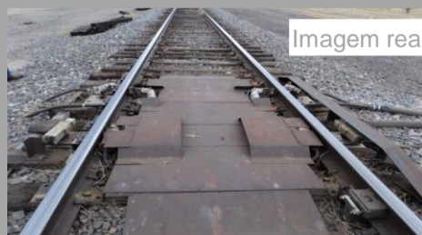
Figura 2: Sistema de monitoramento de rodas ferroviárias apresenta invenção instalado na via
